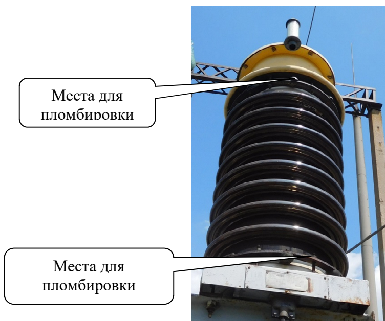
Рисунок 1 – Общий вид трансформаторов напряжения с указанием мест пломбировки
