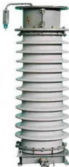
Рисунок 1 – Общий вид трансформаторов напряжения НКФ-110-57У1
