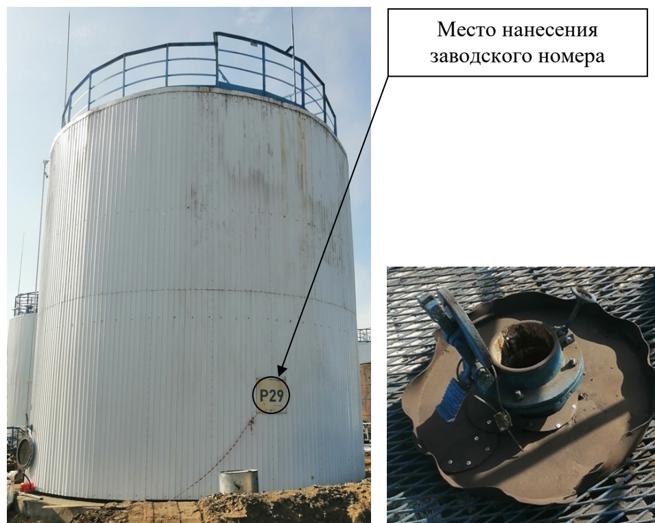
Р и с у н о к 5 – Общий вид резервуара с заводским номером P29 и его замерного люка
