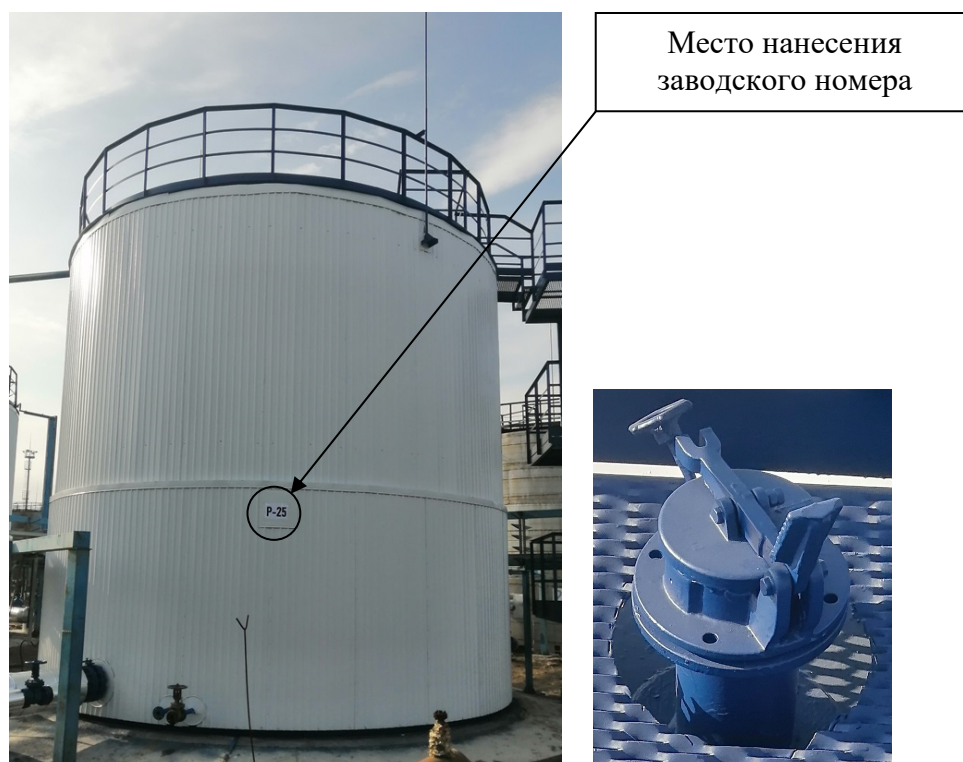
Р и с у н о к 4 – Общий вид резервуара с заводским номером P-25 и его замерного люка
