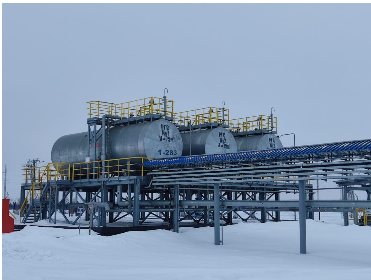
Рисунок 1 – Общий вид резервуаров РГС-75
