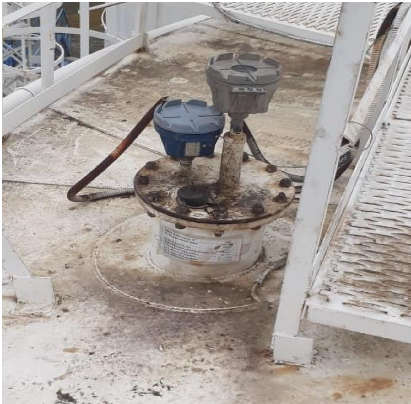
Рисунок 6 - Фотография горловины замерного люка резервуара РВСП-1000 заводской номер 93
