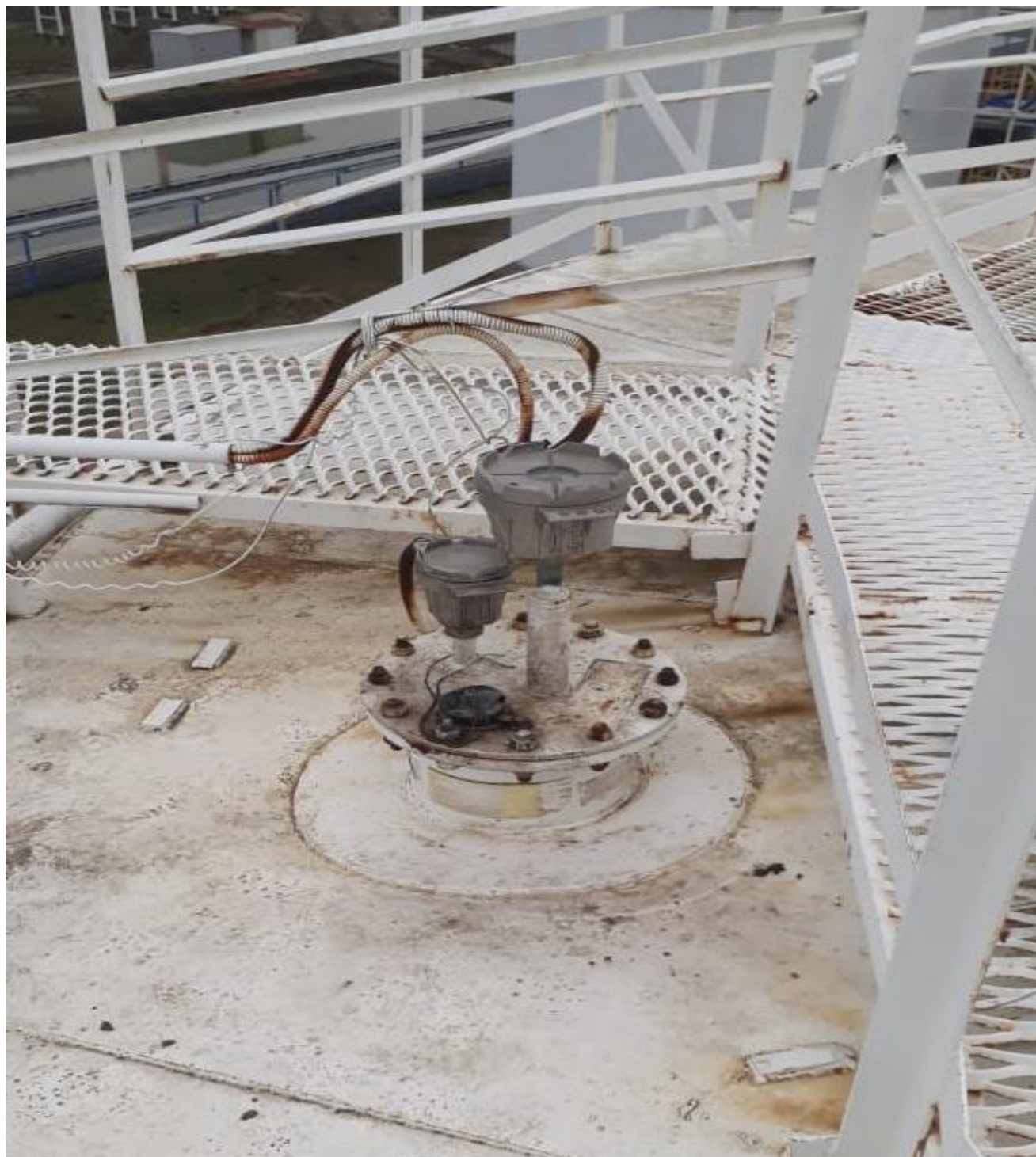
Рисунок 4 - Фотография горловины замерного люка резервуара РВСП-1000 заводской номер 96
