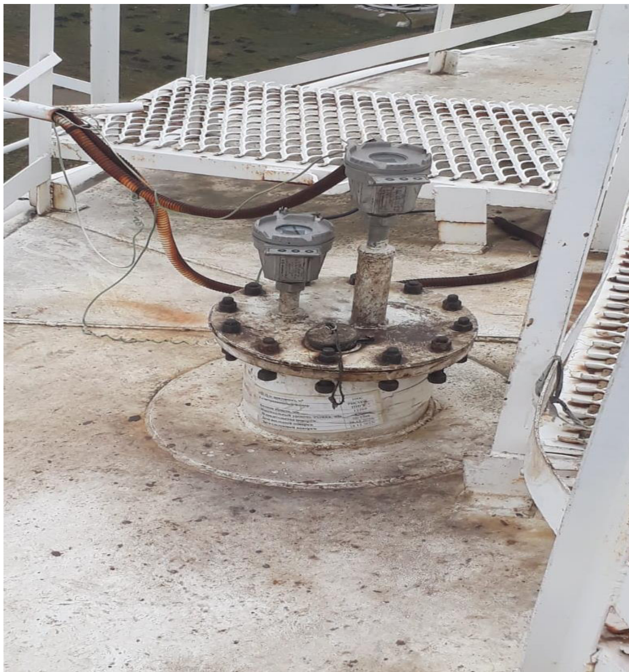
Рисунок 5 - Фотография горловины замерного люка резервуара РВСП-1000 заводской номер 94
