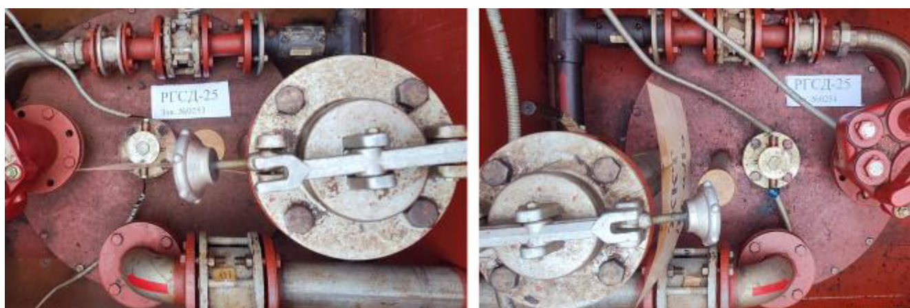
Рисунок 4 – Горловины и измерительные люки резервуаров РГСД-25 зав.№№ 0253, 0254
