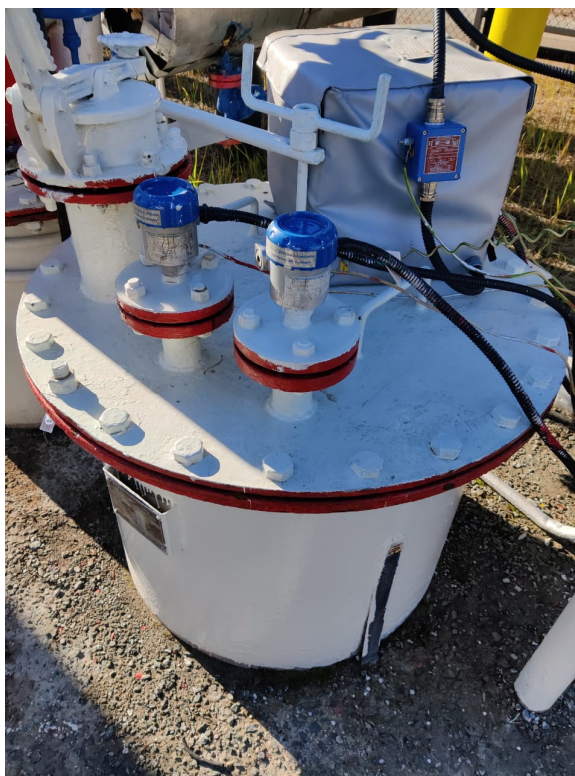
Рисунок 2 – Горловины и замерный люк резервуара.
