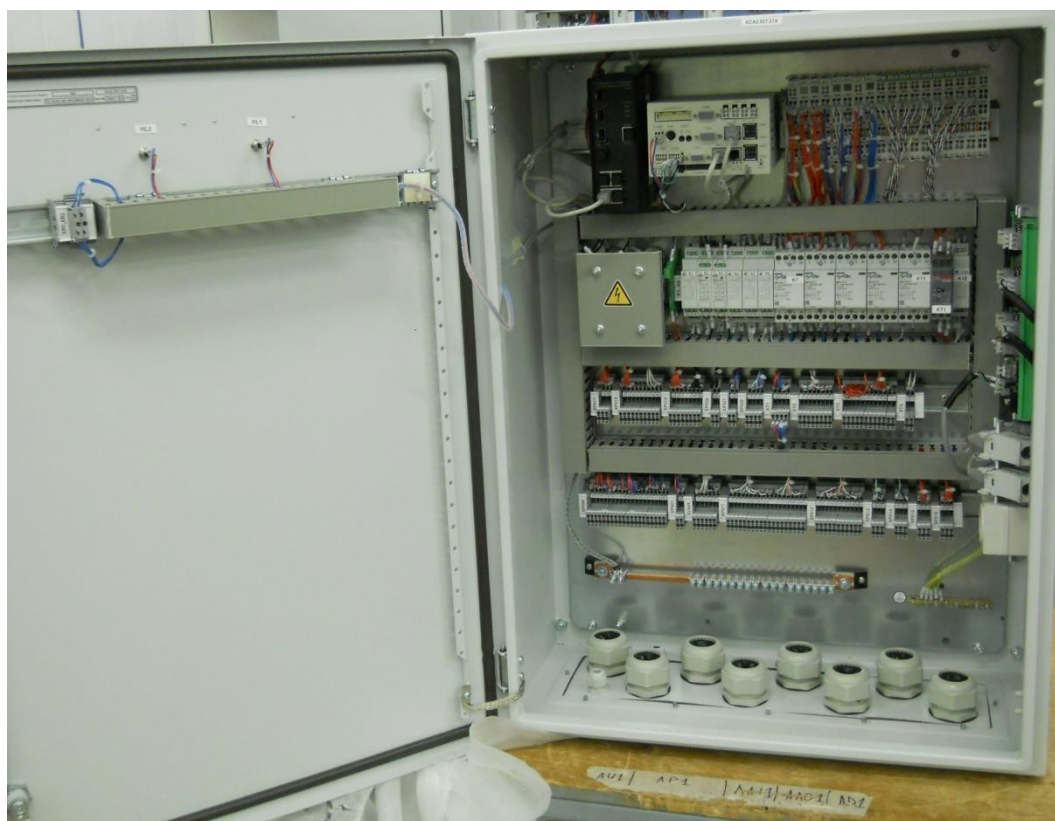
Рисунок 1 – Общий вид шкафа автоматики комплекса
